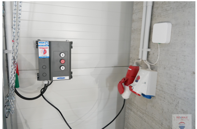
Bedienung Rolltore & Starkstrom
